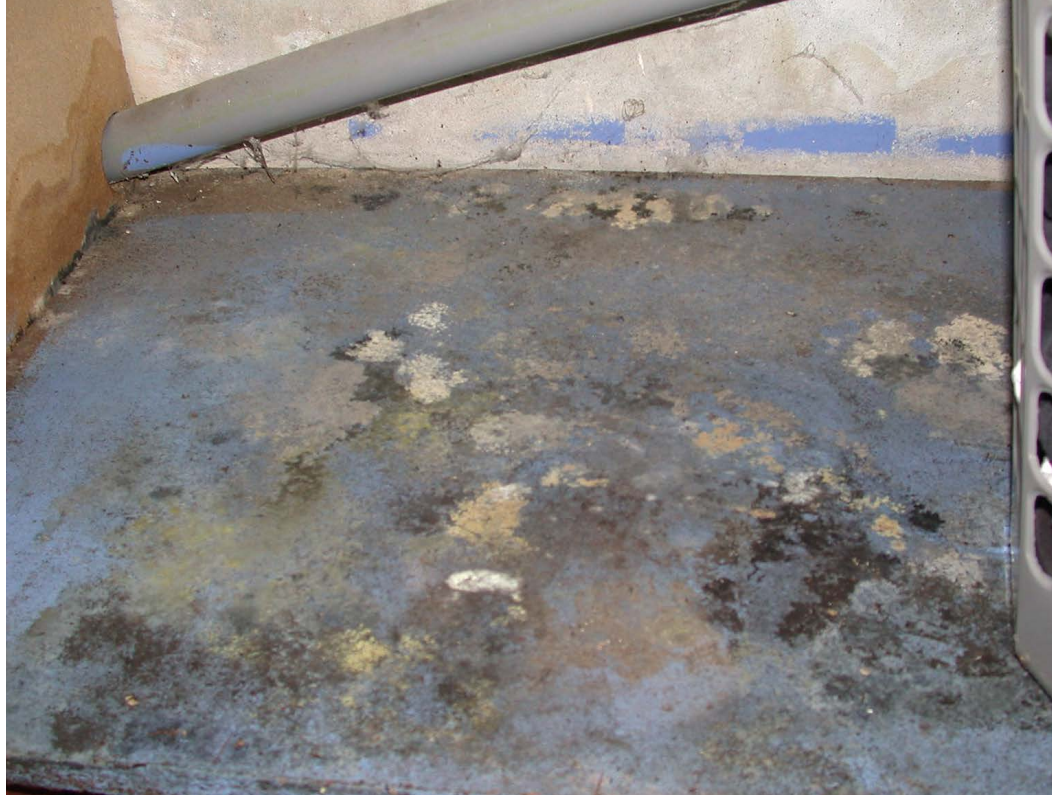
En meget inficeret spånplade i bunden af et vaskeskab i en kælder. Kælderen blev oversvømmet under det store skybrud i 2011 i København. Den blåmalede bundplade viser vækst af Aspergillus spp., Chaetomium spp., Penicillium spp. og Ulocladium spp.
