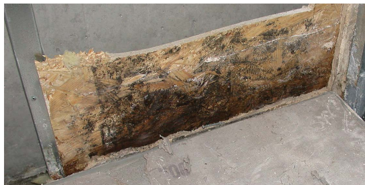
Chaetomium globosum , der vokser på en OSB-plade. På ydersiden har der siddet en gipsplade, og skimmelsvampen har vokset inde i vægkonstruktionen mellem de to plader. Begge plader har suget vand op på grund af en fejlkonstruktion. Foto: Birgitte Andersen
