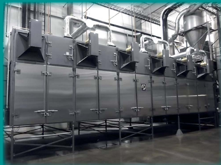
Industrielle varmluft-tørrere er ofte mere end 12 meter lange og 5 meter høje. Tørreprocessen står for mere end 60 % af det termiske energiforbrug ved produktion af fiskefoder.
